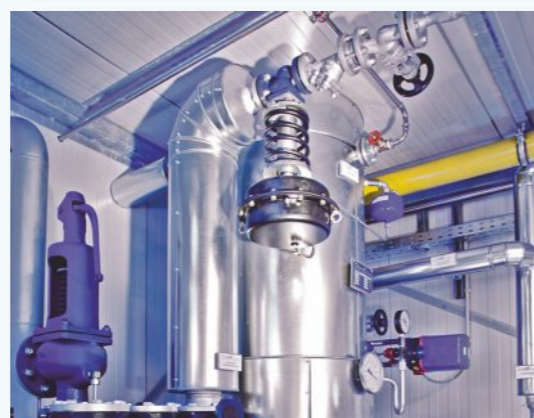
Tanque com domo de desaeração de condensado e água de make-up para caldeiras.
